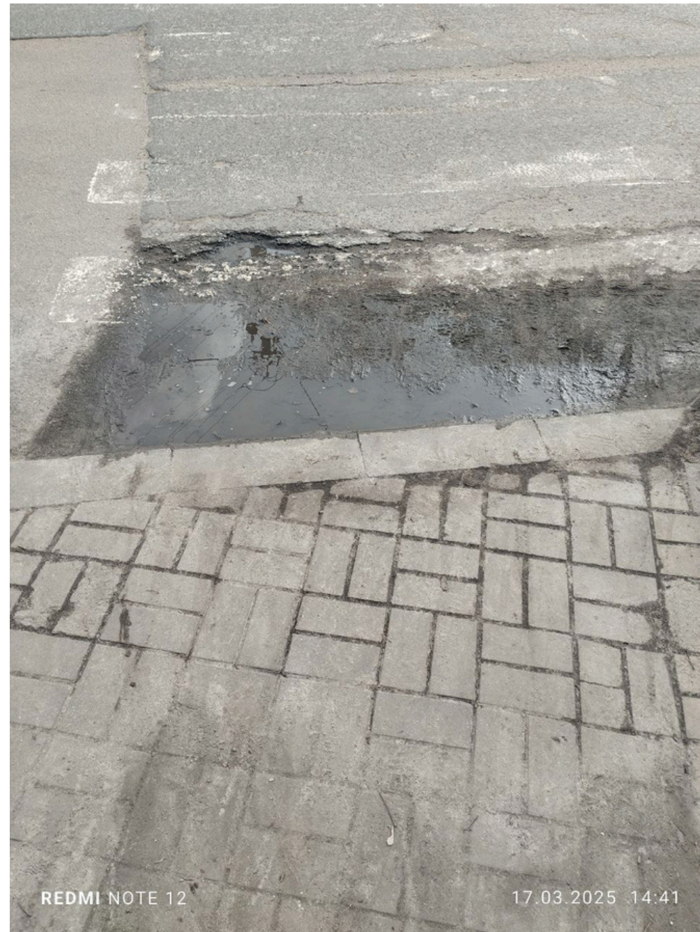
Руйнування дорожнього полотна
