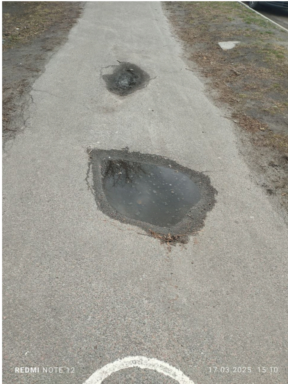
Просідання твердого покриття
