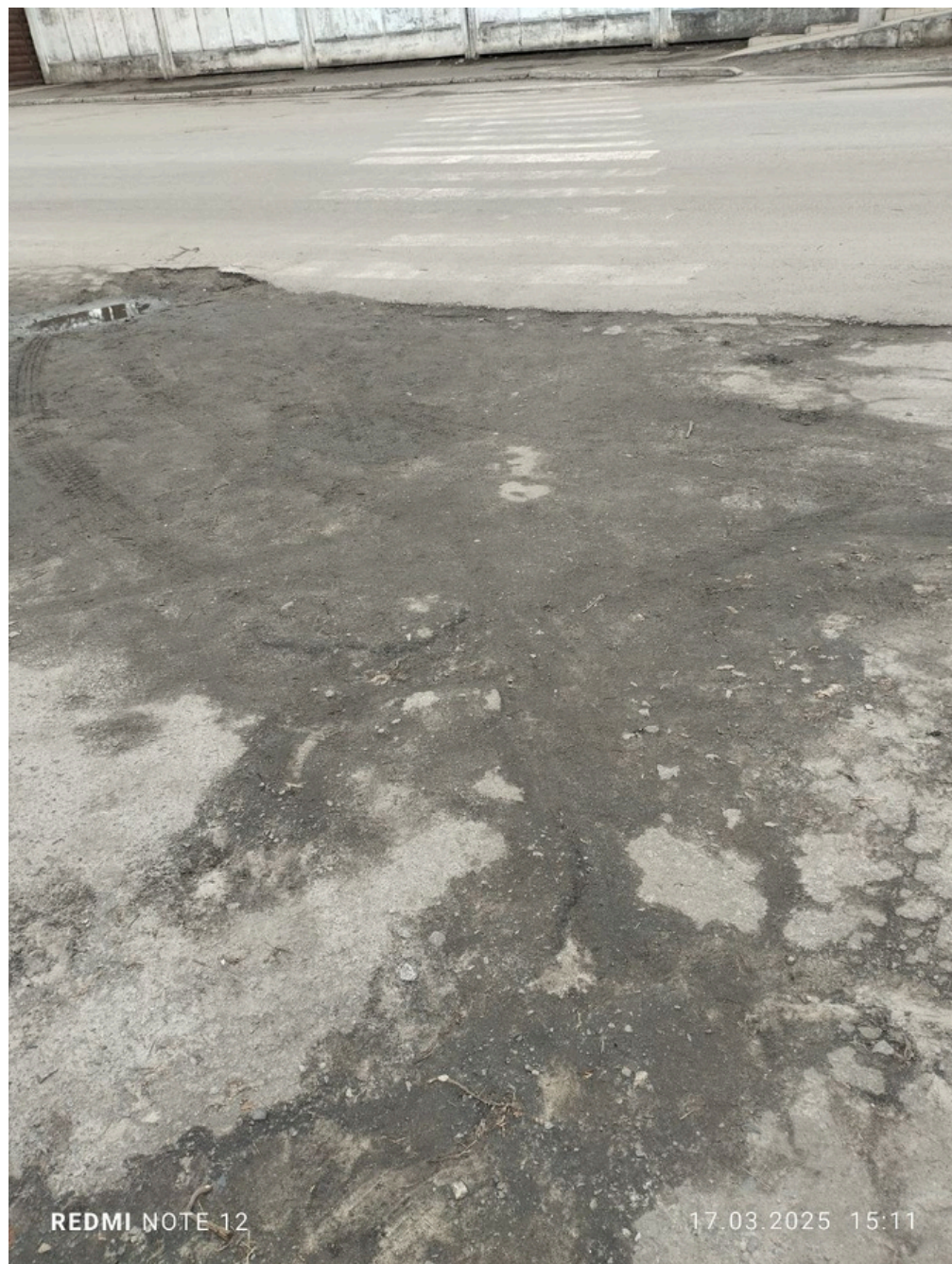
Сітка тріщин на асфальтобетонному покритті
