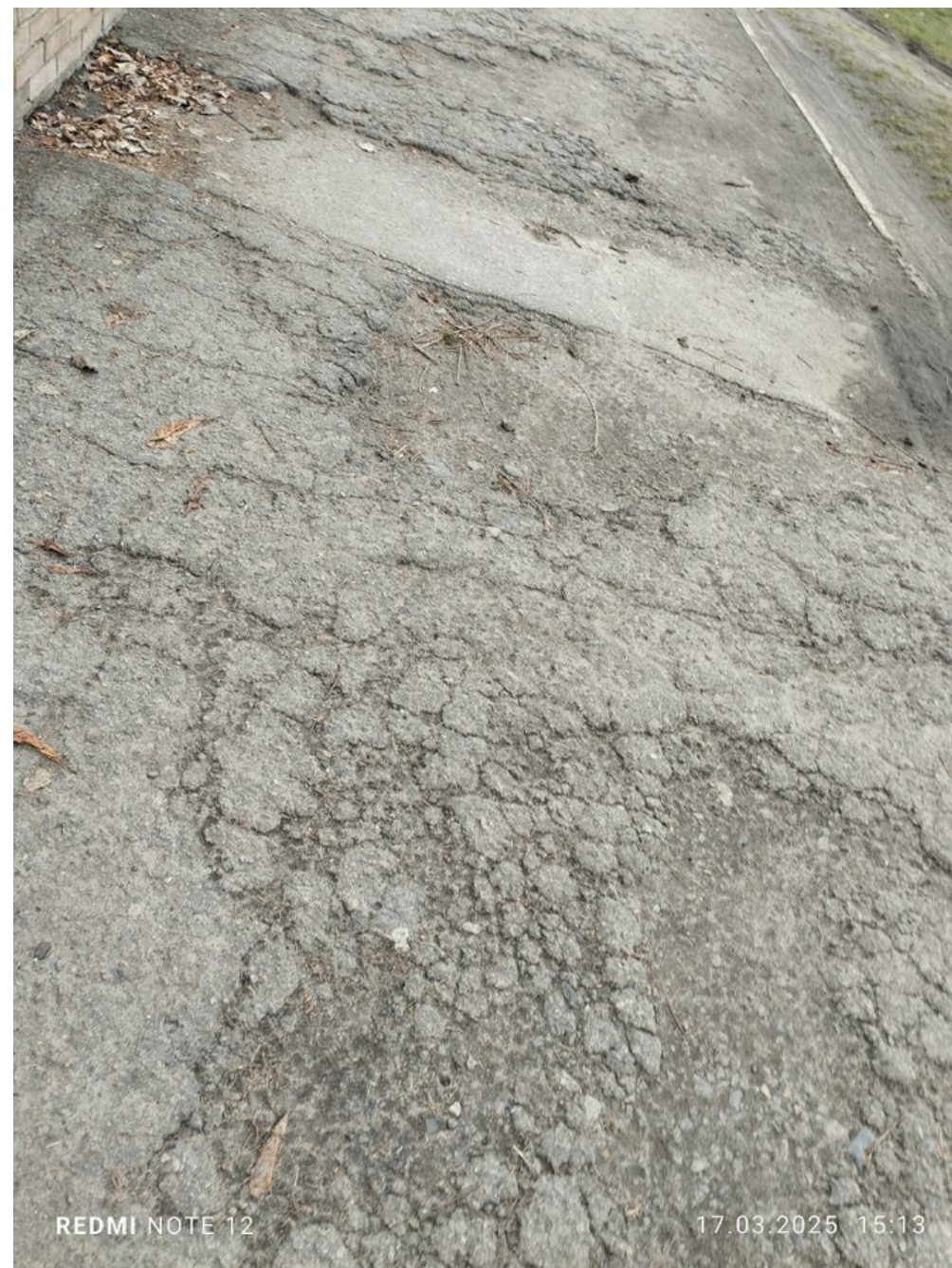
Лущення асфальтобетонного покриття
