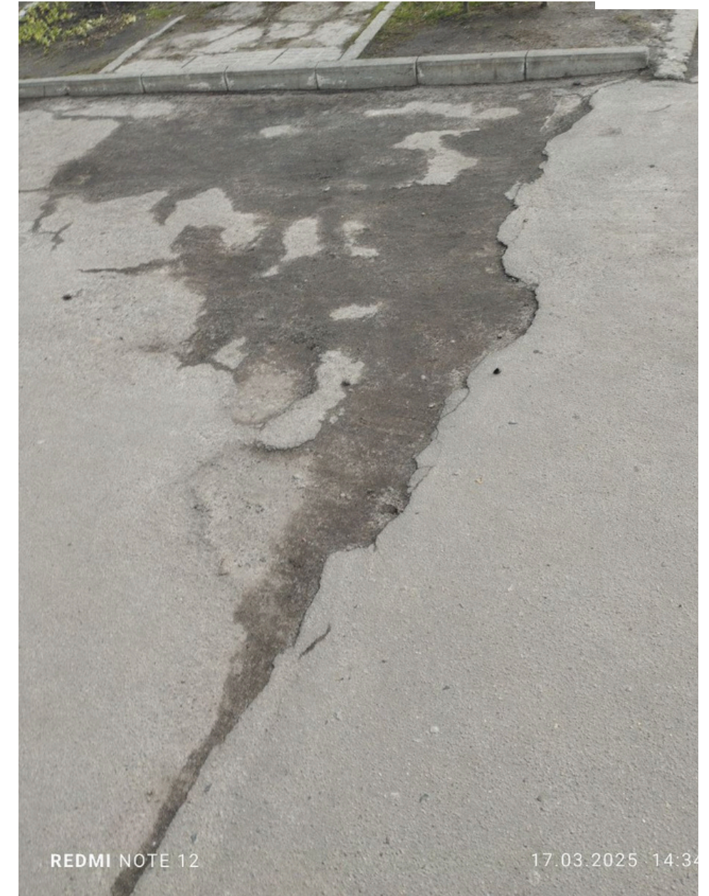
Відшарування асфальтобетонного покриття
